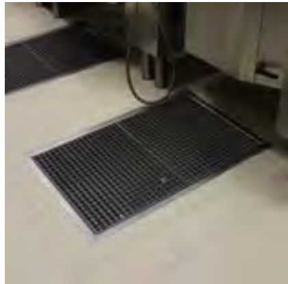
BILD 6. Utslagsbrunn för kokgrytor
