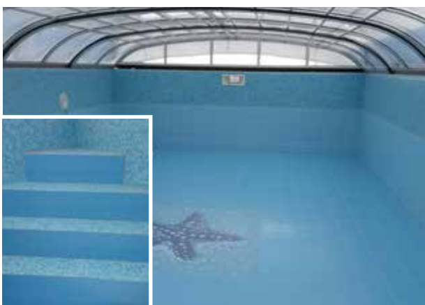
Privat pool utomhus i Tirup, utförd med gjuten betongbotten, väggar av betongsten murade och putsade med nätat B-bruk. System Sopro TDS 823.
