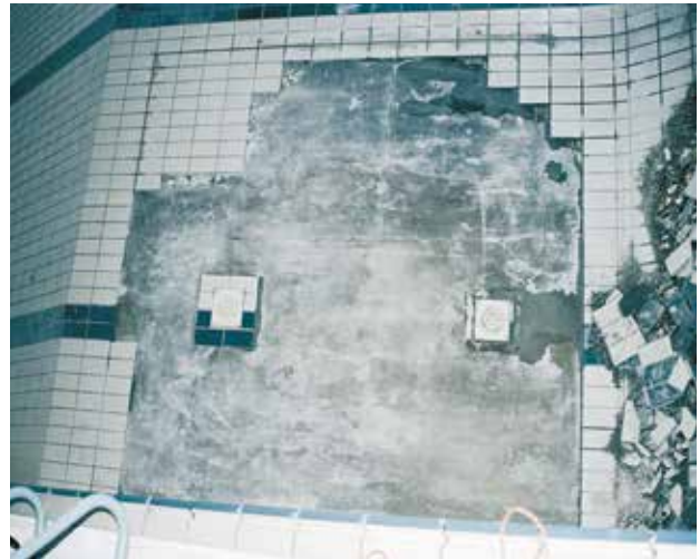
Vidhäftningsproblem p.g.a. vatteninträngning bakom tätskikt.
