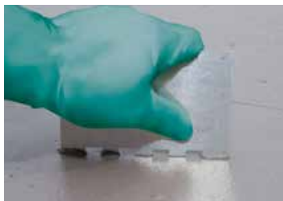
Mät den blöta skiktjockleken, som skall vara ca 1,3 mm, med hjälp av en mätplåt.
