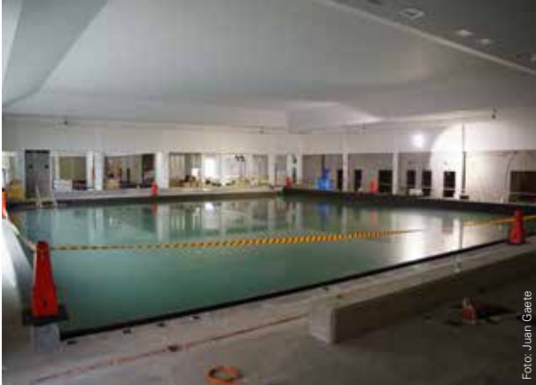
Läckagetest före plattsättning. Tillsatt klor i vattnet, detta underlättar rengöringen efter testet. Testet bör utföras under 14 dagar.
